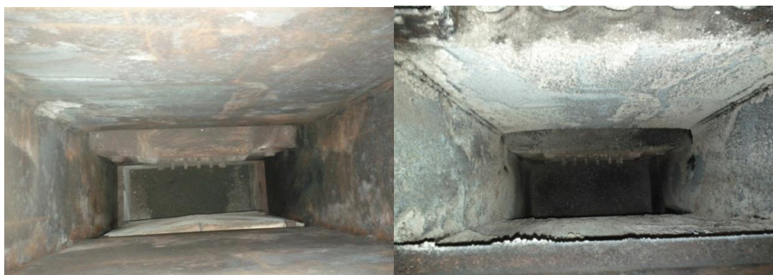
Figure 2. Heat exchanging surfaces of the boiler after and before cleaning Slika 2. Površine kotla na kojima se izmjenjuje toplina nakon i prije čišćenja
